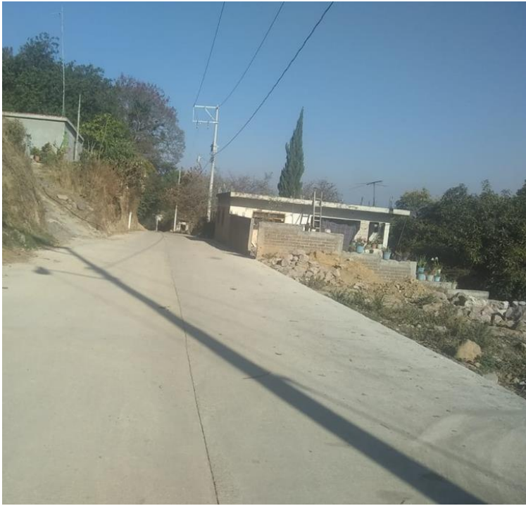
Pavimentación con concreto hidráulico de la calle Pablo Sidar al kínder, de JUMILTEPEC
