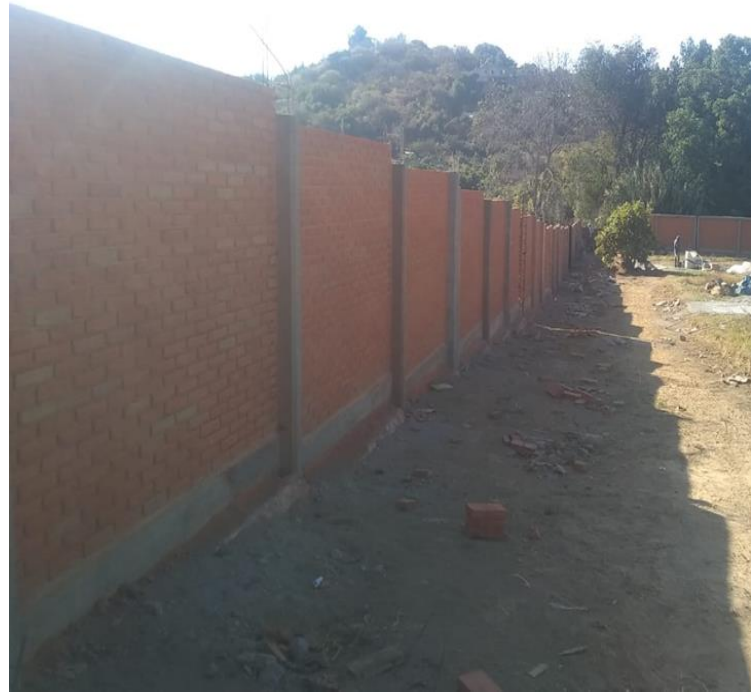
Construcción de barda perimetral en la escuela Primaria Benito Juárez, en METEPEC
