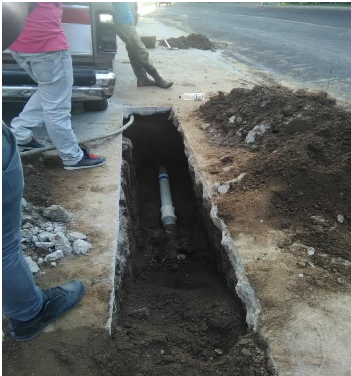
Reparación de una fuga en la red de agua potable en la CABECERA MUNICIPAL
